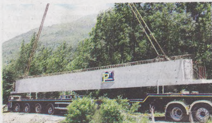
Quatre poutres comme celle-ci ont été acheminées et placées sur le chantier de la voix ferrée Oloron Bedous. © JEAN-LOUIS GAMAURY
